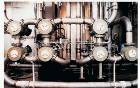
I.S.T. Trevägsväxventil: Flexibel styrning av produktflödet, här ett exempel från färg- och lackindustrin.
